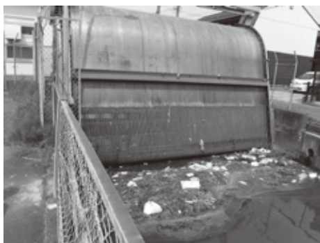
排水機場に流れ着いた ごみの状況
